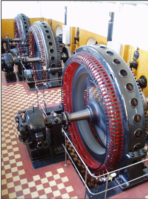
Generatorerne, trukket af turbiner, på Tangeværket ved Bjerringbro
